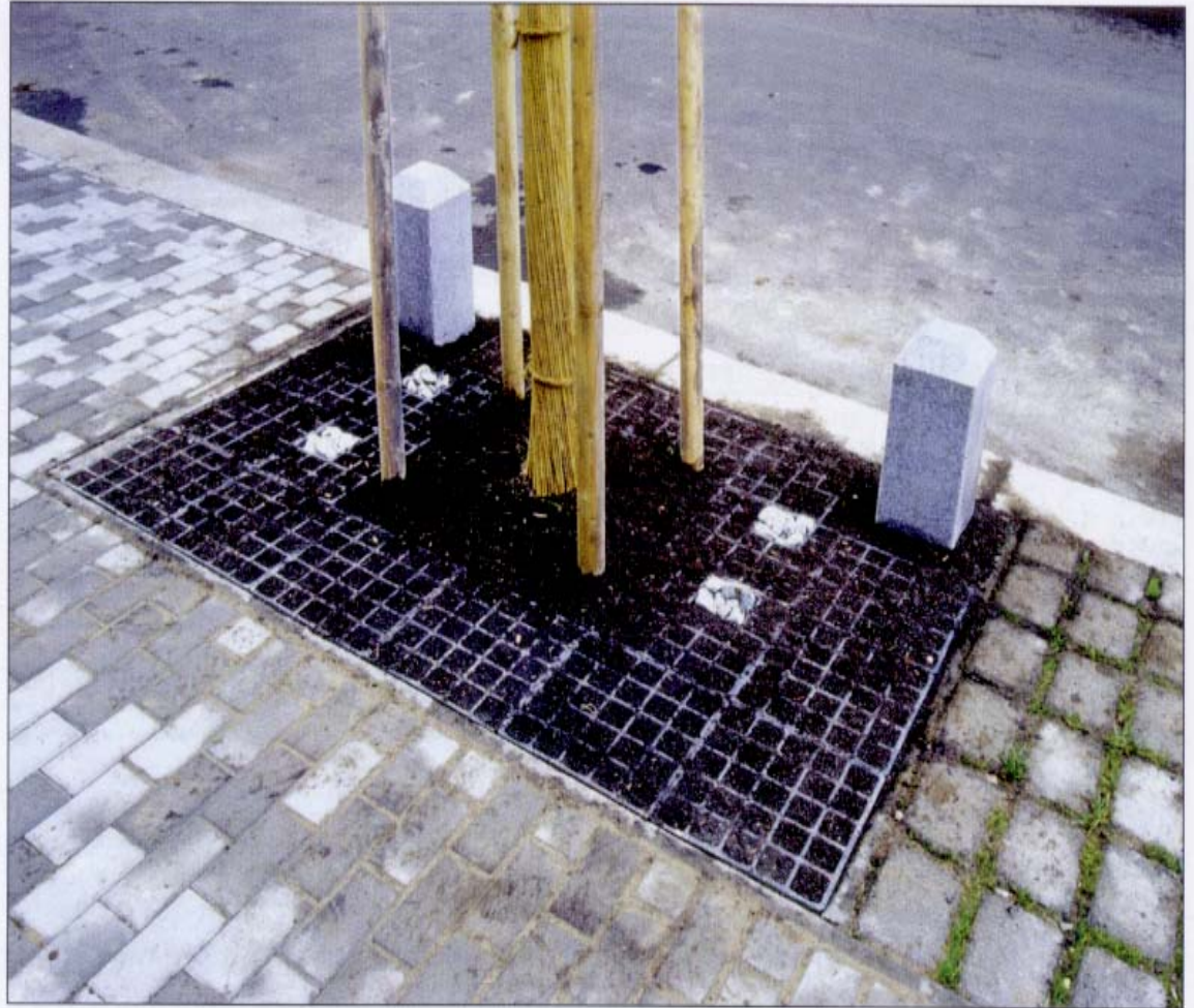
foto.5 Ukončená výsadba ( Tilia platyphylla ) s vyústěním větracích rukávců do zatravnovacích plastových mříží, na kterých byl použit substrát s 50 % podílem písku. Vpravo od vysazeného stromu je propustná dlažba položené na prokořeňovací prvek.
