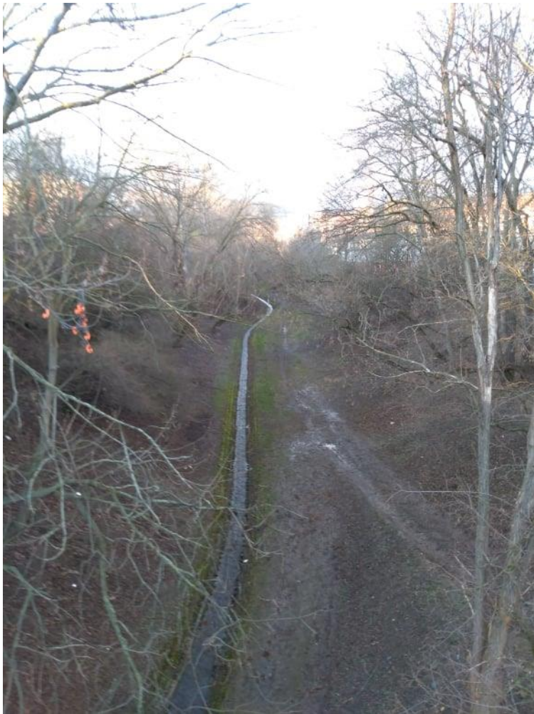
Obr.5: Stav Pokratického potoka na sídlišti
