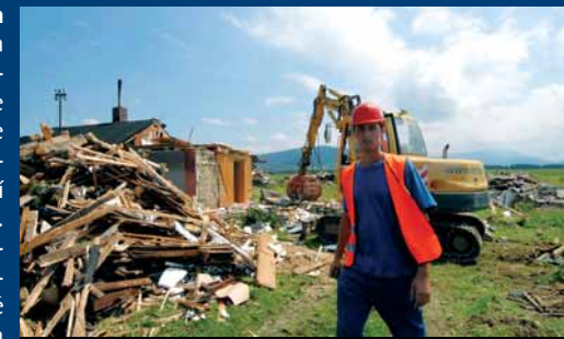
Demoliční práce v Nošovicích na Frýdecko-Místecku v červenci 2006. Rodinné domky musely ustoupit budoucí továrně Hyundai.
