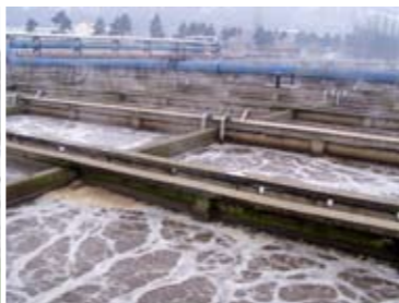
Aktivační nádrže s kalovou vodou v ÚČOV Praha. Foto: P. Hoffmann, fs.cout.cz
