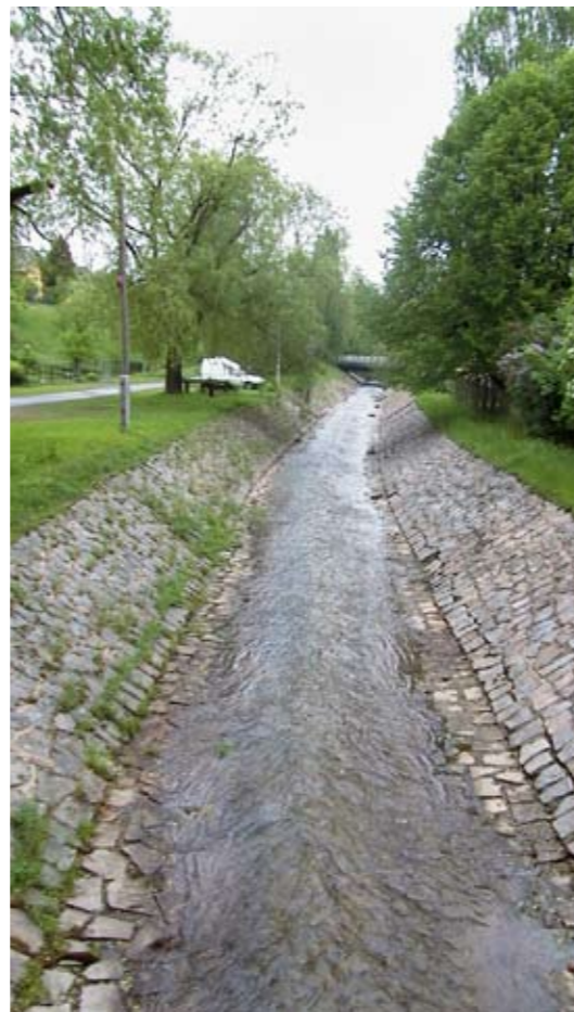
Ukázka zcela degradovaného koryta vodního toku, kde se setkaly všechny tři typy fatálních zásahů: napřímení, zahloubení a opevnění dna i břehů. Voda teče velmi rychle nejkratší možnou dráhou, přičemž biologicky kolonizovatelných povrchů je minimum. Nelze předpokládat jakékoli samočistící procesy. Podobné úpravy u nás postihují zejména drobné vodoteče, které jsou ovšem z pohledu samočištění nejdůležitější, protože představují kolem 90 procent délky celé říční sítě a přijímají nejen odpadní vody z drobných obcí, ale také např. splachy pesticidů z polí a další. Foto: J. Duras
